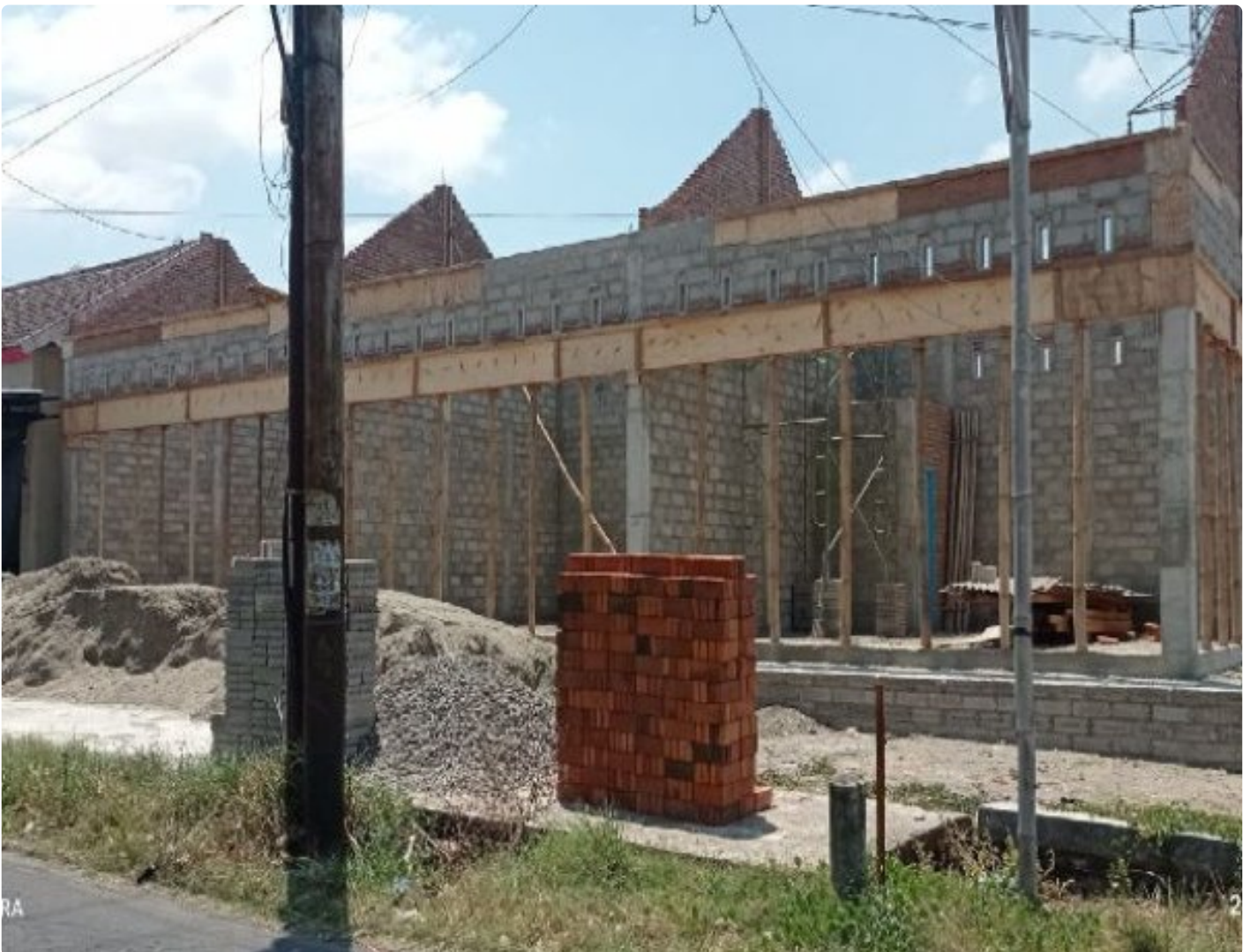
Proses pembangunan tiga kios milik Pemdes Gogorante guna tingkatkan PAD. (Foto: prijo atmodjo)
